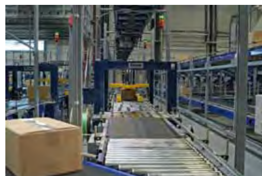
Een deel van wat operations manager Marco van Etten de 'aorta' van het systeem noemt: de automatische dozensluiters en omsnoeringsmachines
